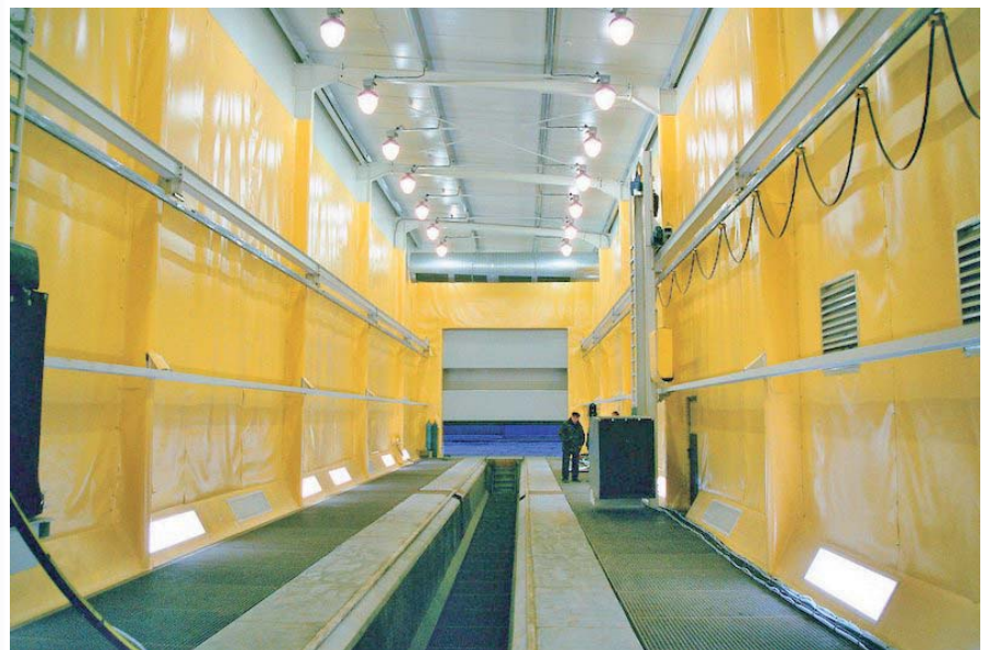
Strahlhalle mit SAPI Flachfördersystem, Arbeitsgrube und Fahrspuren für Eisenbahn
