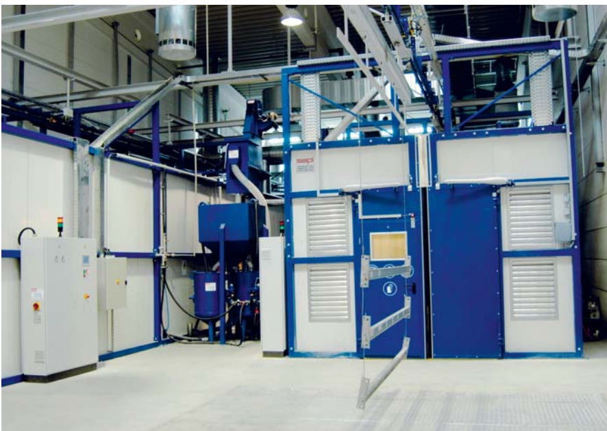
Zwei Strahlhallen SPS gesteuert zum Sweepen von verzinkten Oberflächen und Sandstrahlen mit automatischen Toren, Förderanlage für Werkstücke
